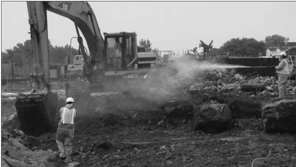
La excavación es el método elegido para la limpieza del sitio de Garfield Avenue, que PPG ha llevado a cabo desde julio como parte de la limpieza inicial.
